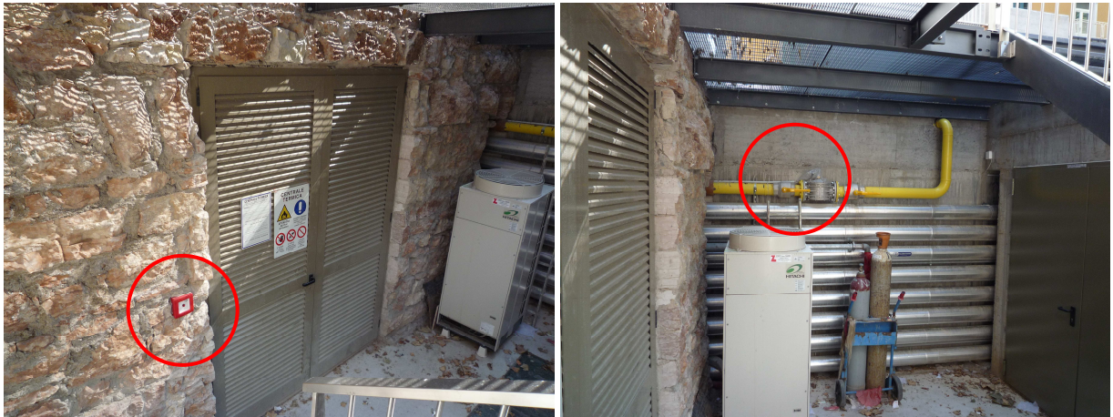
Pulsante di sgancio della corrente e valvola per l'intercettazione del metano
